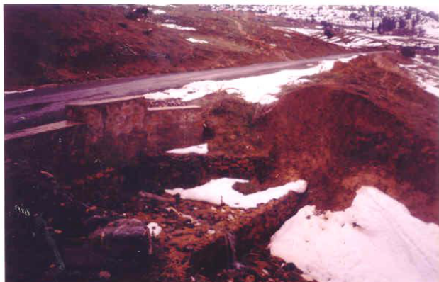
Figure 2: Des pluies diluviennes se sont abattues sur la région de Ouzera. Durant 24 h, les 4, 5, 6, 7 seuils en gabion ont basculé vers l'aval après ce déluge.
